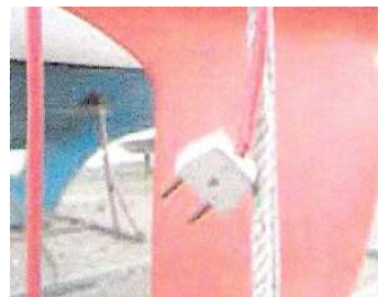
Under sommerens gennemgang i Havnen blev der konstateret en del ulovlige og dårlige-holdte ledninger og stik
